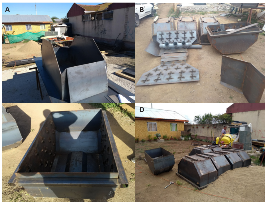
Figura 2.2. Proceso de construcción de moldes de Arrecifes Artificiales Tipo Nicho, AATN. A) Ensamble de las láminas. B) Molde extendido, se observan las bisagras y las cruces que servirán de soporte al armado de tubos. C) Marco metálico (candado) que cierra los lados del molde. D) Serie de moldes construida.
